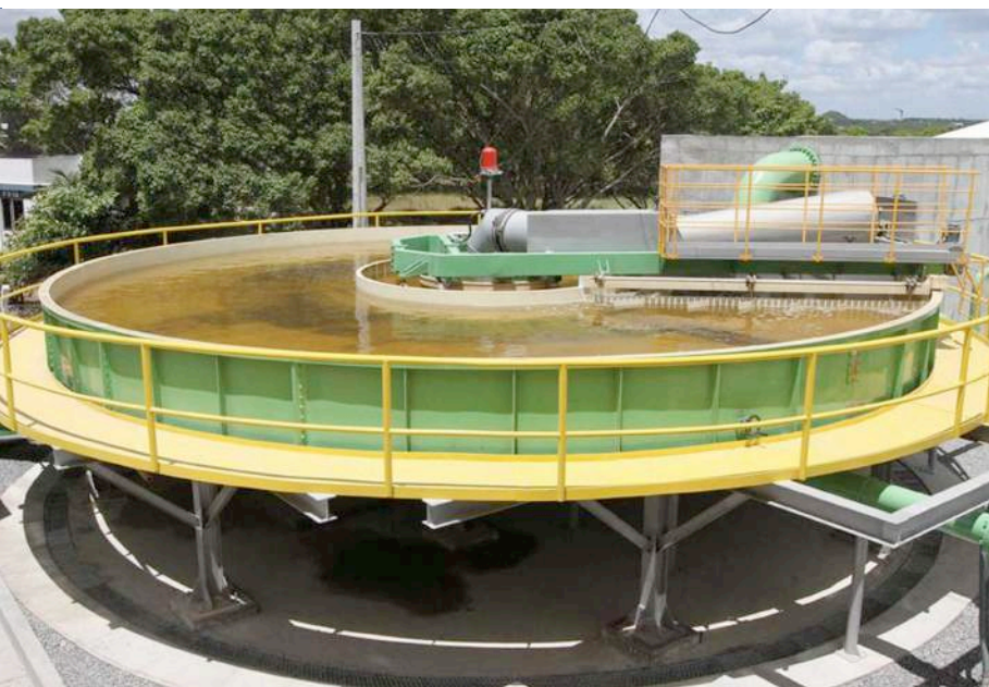
Sistema de tratamento de água
